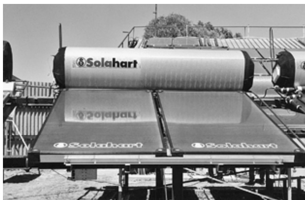
Speicheranordnung auf dem Dach
